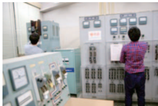
遮断実験用の配電盤
